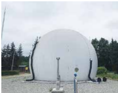
Zbiornik dwupowłokowy biogazu o pojemności 700 m 3
